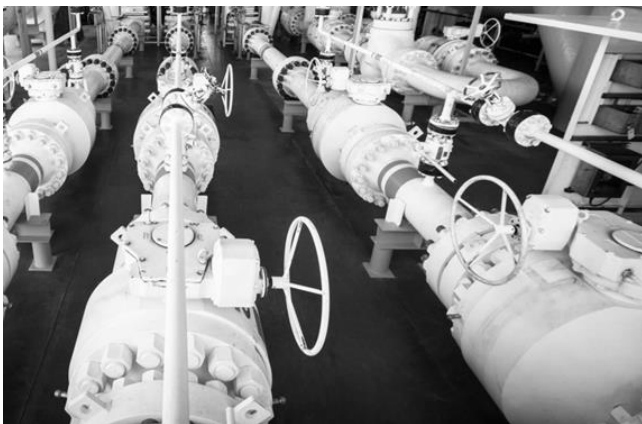
Abb. 1: Mess- und Regelanlage (Beispielfoto)
